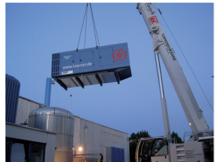
EON Bayern AG 2x 1.000 kVA Notstromaggregat in Sonderbau, Spannung 20 kV
