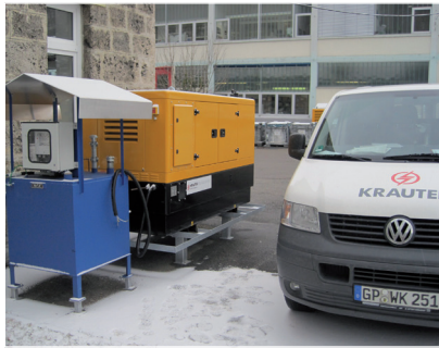
Eismann AG 60 kVA Notstromaggregat mit doppelwandigem Tank für Wasserschutzgebiet
